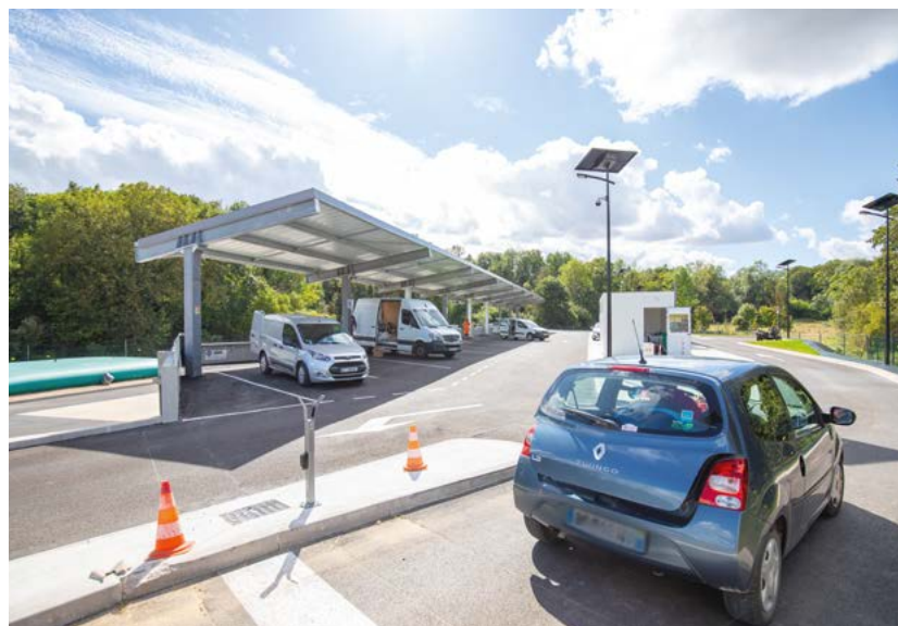
120 panneaux photovoltaïques ont été posés sur les ombrières de stationnement. En plus de profiter au site, l'électricité produite alimente les locaux du pôle territorial.
