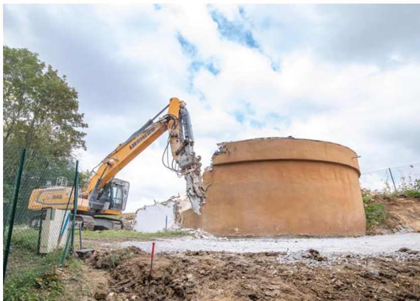
Le volume du nouveau réservoir sera identique au précédent, soit 500 m 3 .
