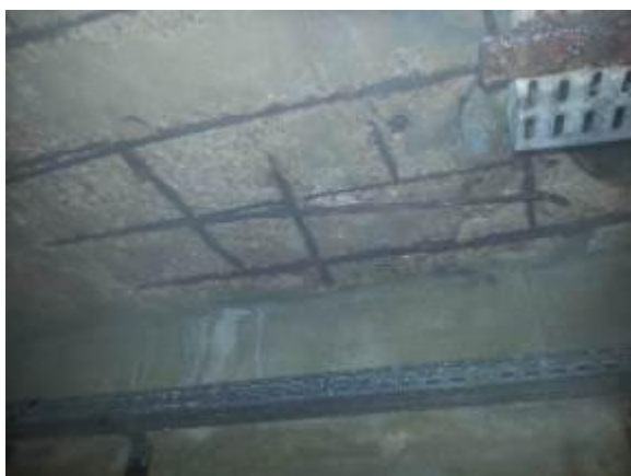
Fers à béton apparents
