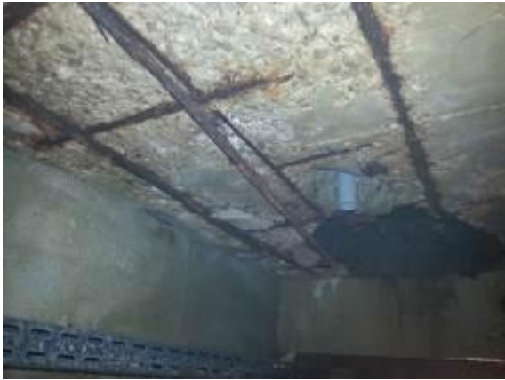
Fers à béton apparents.
