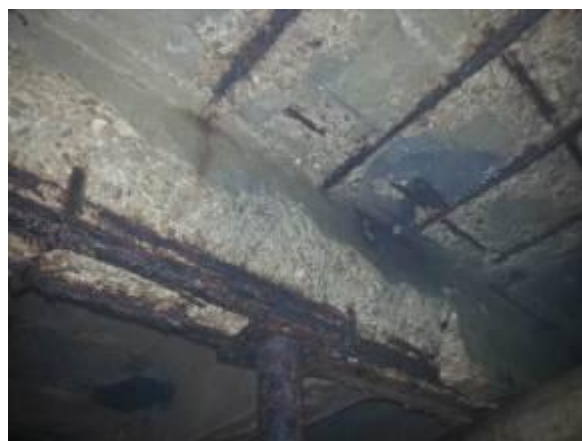
Fers à béton apparents – Soutènement corrodé fortement
