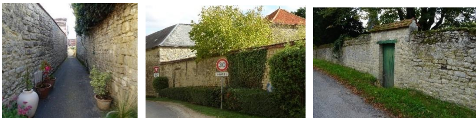
Murs de clôture : impasse de la Brigole à Trigny – Rue de l'Église à Châlons - Chemin derrière la Ville à Chenay
