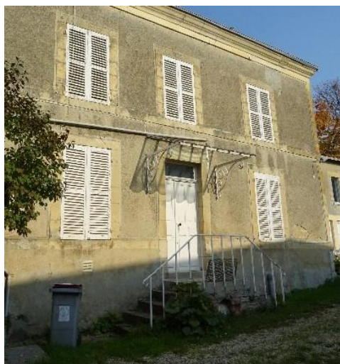
Type 2 : Les façades en maçonnerie enduite et encadrements de baie en pierre de taille - Exemple rue Philibert à Chenay
